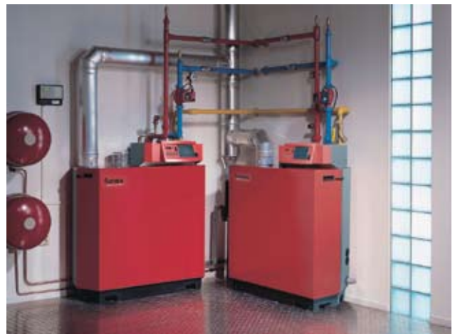
3. Remeha Gas 210 ECO. Vermogen van afgebeelde opstelling: 400 kW
